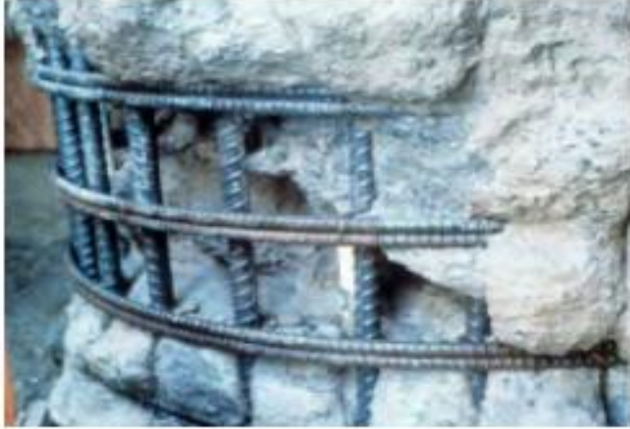
Şekil D.2 Diyafram duvarı ve kazıktaki kalıntılara örnekler (kazık fotoğrafı Şekil 9.14b, FHWA GEC10'dan alınmıştır).
