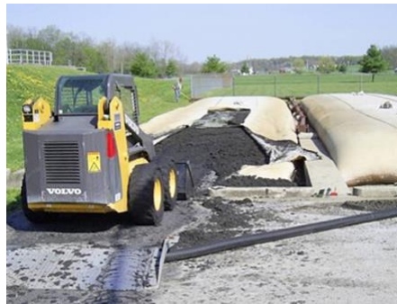
Şekil 5.17 Pasif çamur susuzlaştırma için filtreleme torbaları
